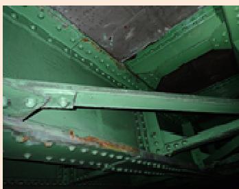
主桁の損傷（腐食）
