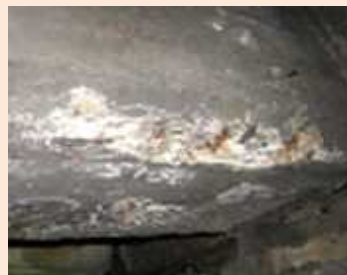
主桁の損傷（鉄筋露出）
